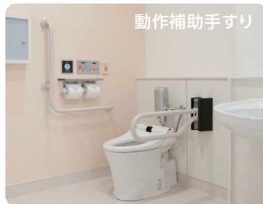
歩行補助手すり
