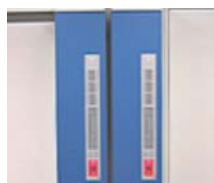
ガス消火装置
