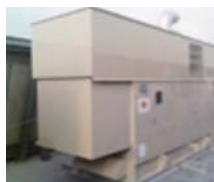
非常用発電機
