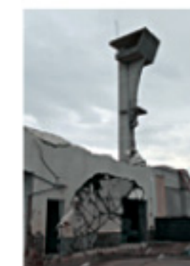
名取市閑上。魚市場のコンクリート構造物に残る津波の爪痕
