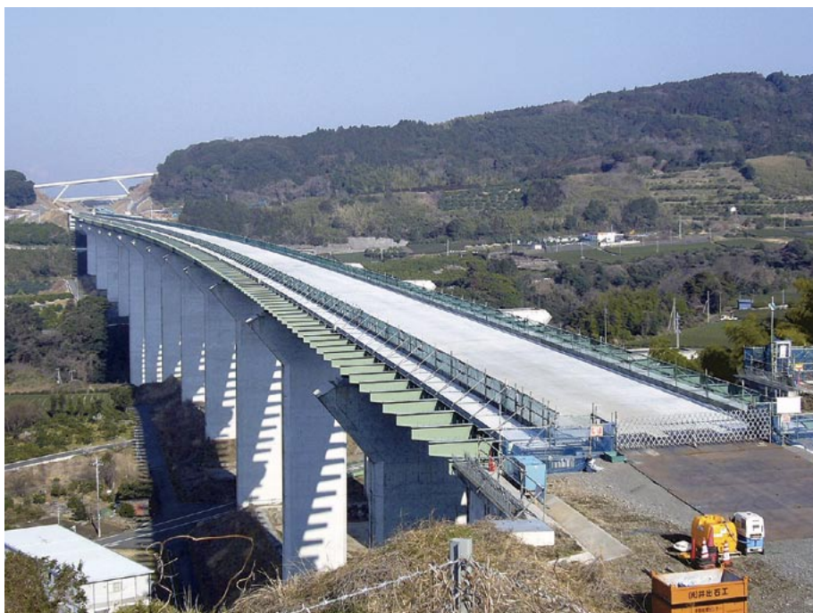
須津川橋下り線の工事現場。供用前に拡幅することとなり、拡幅部の鋼材を設置した様子。床版を設置すれば完成だ (写真:中日本高速道路)
