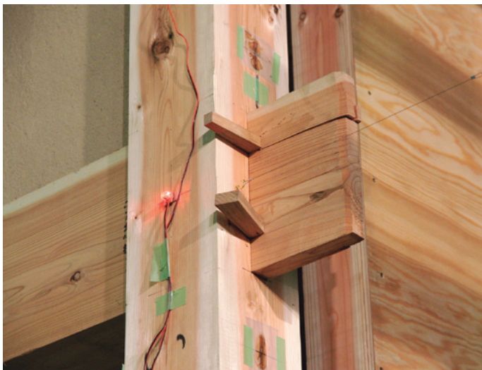
08年に実施された実験では、柱は折れなかった。代わりに小壁の土塗り部分が大きくひび割れ、差し鴨居の端部が割れているのがわかる
