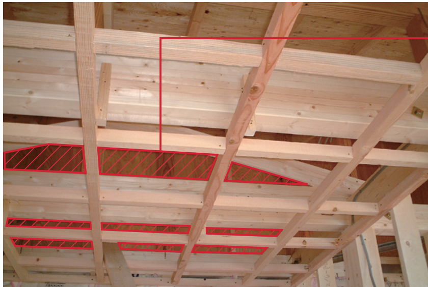
妻壁、根太と根太の間に防火被覆がない
