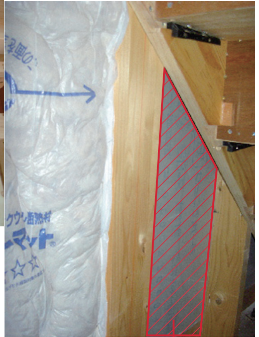
階段の側壁に防火被覆がない
