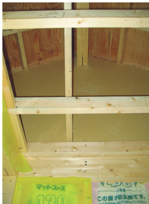
天井を張る前に妻側の防火被覆を施工に変えることで、作業負担を軽減した現場
